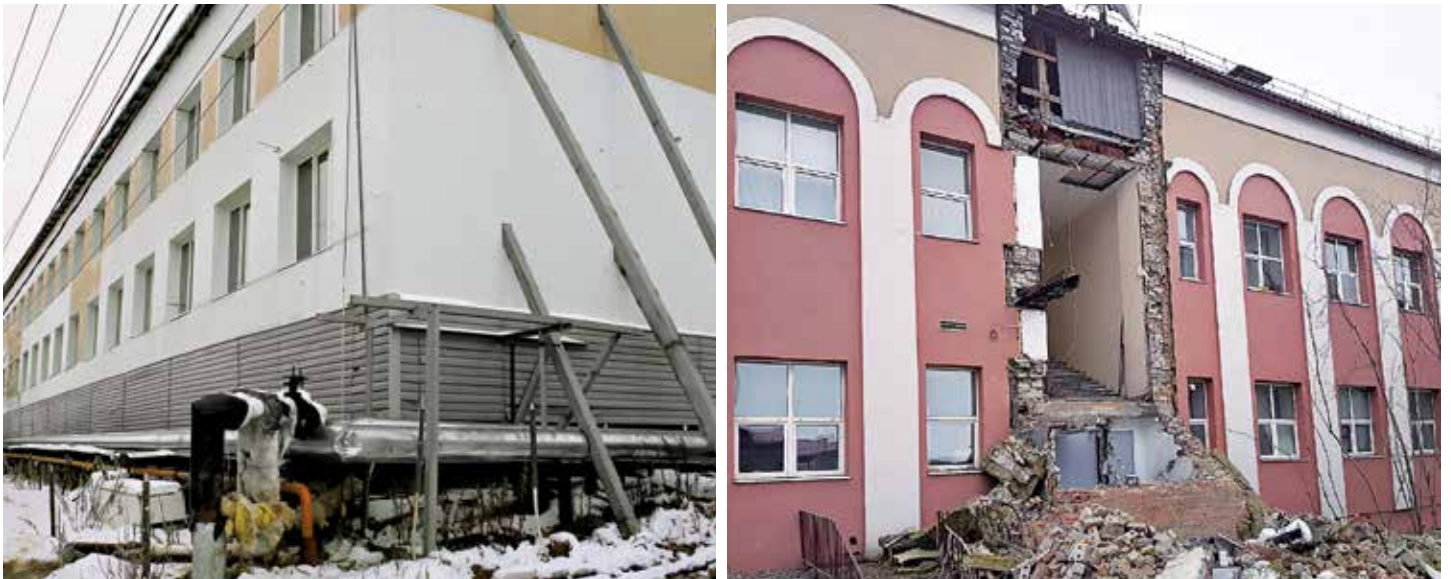
Рис. 4 – Аварийные здания Ямальского полярного агроэкономического техникума и Окружного центра национальных культур, г. Салехард, апрель 2020 г.
